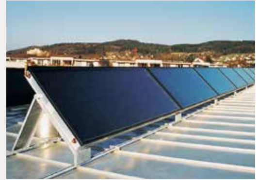
COBRA Kollektoren für QUICKSOL im Mehrfamilienhaus.
